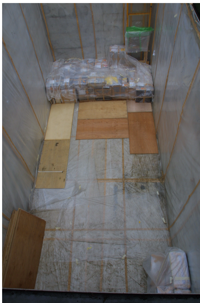
図 3.4.3-3 平成 17 年度下期 排気フィルタ取出し作業終了後の保管廃棄施設内の状況
